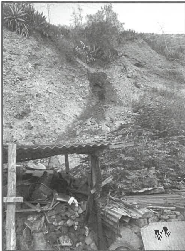
Figura 7.5.18. Punto Crítico PC-07. Vista del Punto Crítico PC-07, donde se observa un talud de fuerte pendiente con procesos activos de erosión superficial, desprendimiento de material y formación de cárcavas ocasionadas por la escorrentía de aguas pluviales. Estas condiciones evidencian la inestabilidad del terreno y representan un riesgo potencial para la estabilidad del canal de conducción, por lo que se recomienda la ejecución de obras de estabilización geotécnica, protección contra la erosión y control del drenaje superficial.
