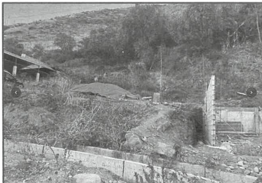
Figura 7.5.14. Punto Crítico PC-06. Vista del Punto Crítico PC-06, donde se aprecia un talud con cobertura vegetal y evidencias de excavaciones e intervenciones antrópicas en su base. Estas condiciones podrían favorecer procesos de erosión e inestabilidad del terreno, por lo que se recomienda implementar medidas de estabilización y un monitoreo periódico para prevenir afectaciones al canal de conducción.
