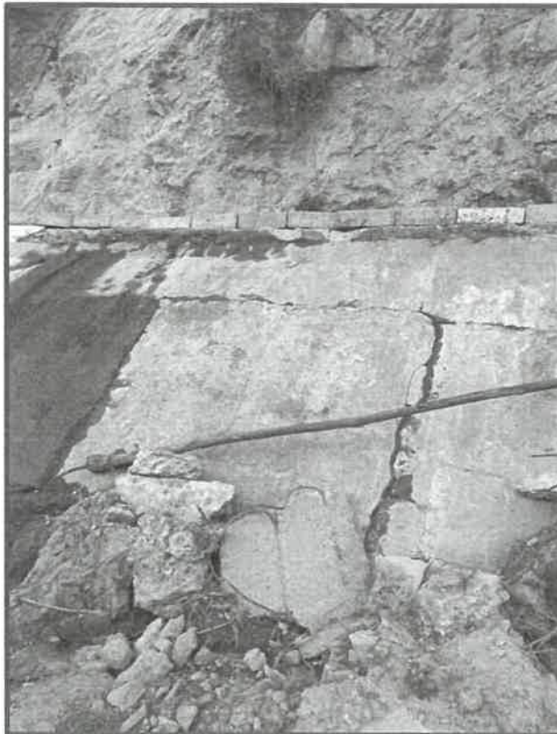
Figura 7.5.4. Punto Crítico PC-01. Detalle de las patologías estructurales identificadas en el revestimiento de concreto del canal de conducción, donde se observa la presencia de fisuras longitudinales y transversales, separación entre paños, desplazamiento de elementos de concreto y pérdida de continuidad estructural, asociados a deformaciones diferenciales originadas por la inestabilidad del terreno de fundación. Asimismo, se aprecia el desprendimiento de fragmentos de concreto y la acumulación de material producto de procesos de erosión y socavación en la base del talud, evidenciando un estado avanzado de deterioro que compromete la estabilidad del revestimiento y requiere la ejecución de obras de estabilización geotécnica, rehabilitación estructural y control integral del drenaje superficial.
