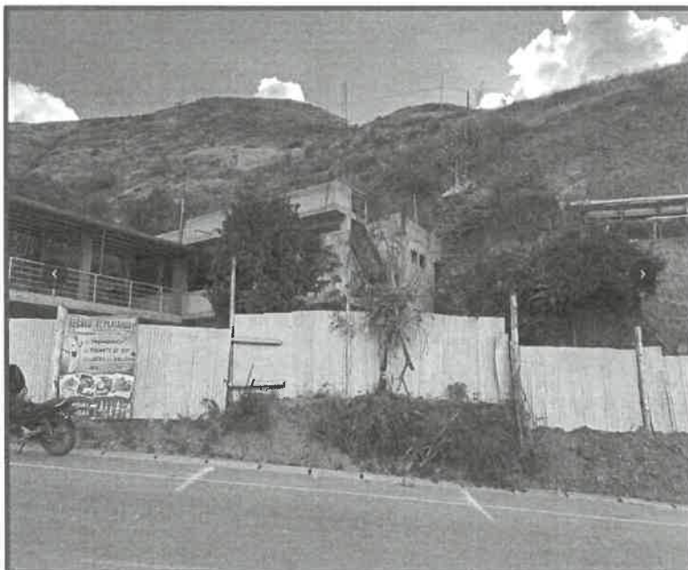
Figura 7.5.10. Puntos Críticos PC-03 y PC-04. Vista del talud ubicado aguas arriba del canal de conducción, donde se observa un deslizamiento superficial desarrollado detrás de las viviendas existentes. La pérdida de estabilidad del terreno evidencia procesos de erosión e infiltración que incrementan el riesgo de afectación al canal de conducción y a las edificaciones colindantes, requiriéndose medidas de estabilización geotécnica y control del drenaje superficial.
