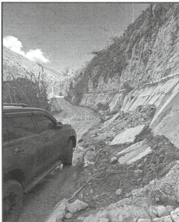
Figura 7.5.3. Punto Crítico PC-01. Vista del sector correspondiente al Punto Crítico PC-01, donde se observa el deterioro del revestimiento de concreto del canal de conducción, evidenciado por el desplazamiento y desprendimiento parcial de las losas de protección, producto de procesos de erosión superficial, pérdida de soporte del terreno y movimientos localizados del talud de corte. Asimismo, se aprecia la acumulación de material desprendido sobre la plataforma de circulación, condición que reduce la estabilidad del corredor hidráulico y evidencia la necesidad de ejecutar trabajos de estabilización del talud, rehabilitación del revestimiento y control del drenaje superficial para prevenir la progresión del deterioro.
